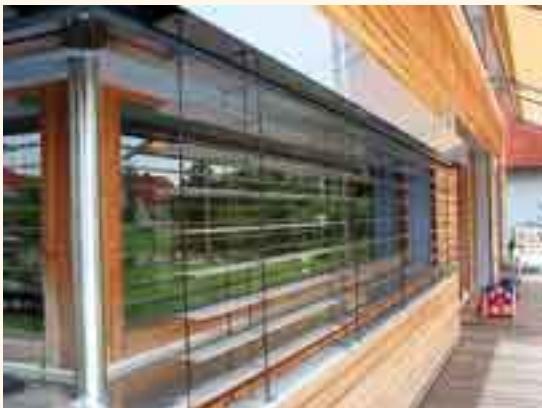
Außenliegende Jalousien auf der Süd- und Westseite
