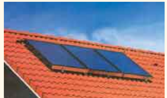
Zur Montage der Kollektoren eignen sich schattenfreie Dachflächen
