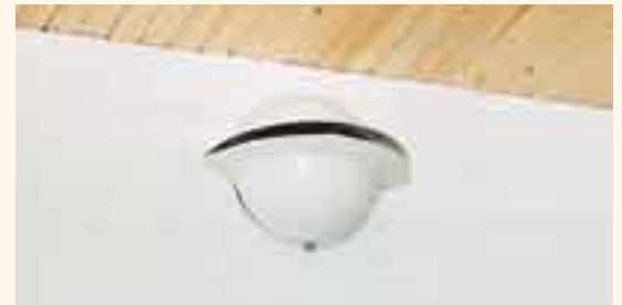
Von der Lüftungsanlage sieht man im Wohnraum nur die Zuluftdüse. Sie hat ca. 12 cm Durchmesser.
