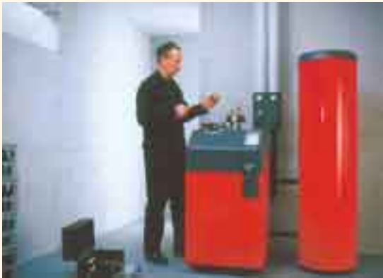
Moderner Niedertemperaturkessel mit Warmwasserspeicher
