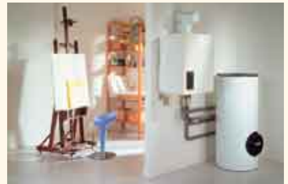
Heizungsanlage im Wohnraum
