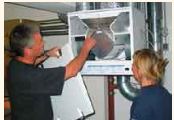
Das Lüftungsgerät für die zentrale Be- und Entlüftung mit Wärmerückgewinnung
