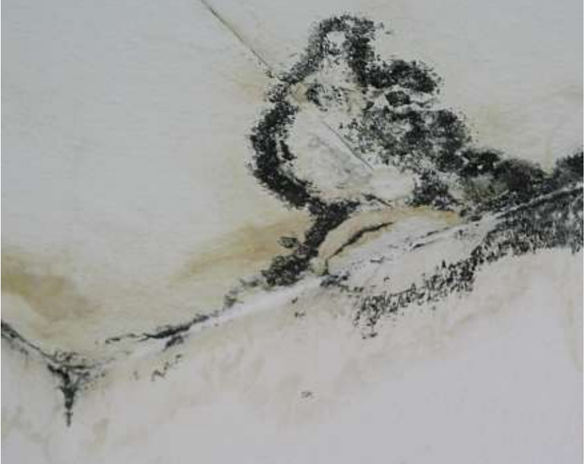
Küf mantarından oluşan lekeler örnek
